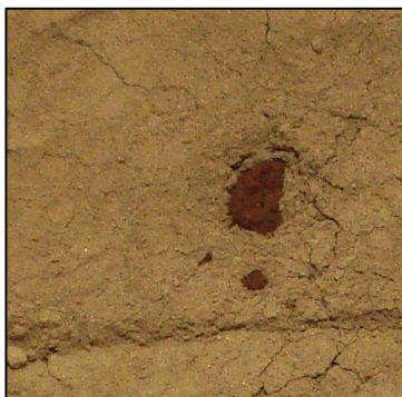
Figura 48. Manchas de tipo goteo sobre superficie terrosa.
